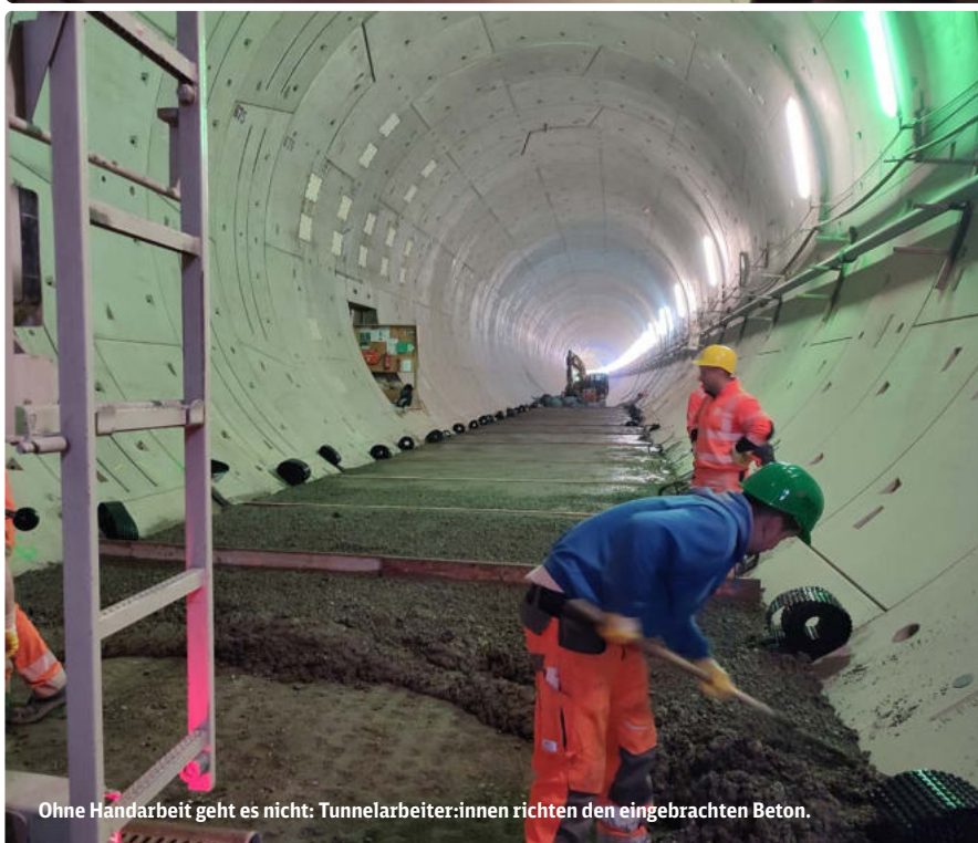
Der Beton wird vor Ort hergestellt und mit Fahrmischern in den Tunnel gefahren.
