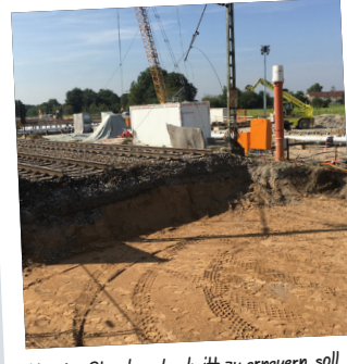
Um den Streckenabschnitt zu erneuern, soll eine Betonplatte errichtet werden. Dafür wird zuerst Erde ausgehoben.
