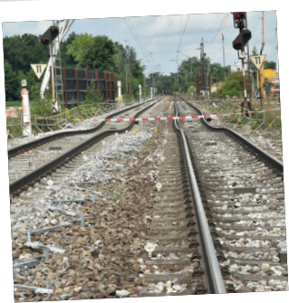
Am 12. August sinken die Gleise der Rheintalbahn ab, die Strecke wird gesperrt.
