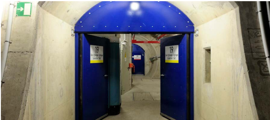
Verbindungsstollen mit Rettungsschleuse im Katzenbergtunnel
