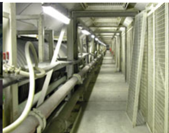
Endlos wirkender Gang in der Tunnelvortriebsmaschine
