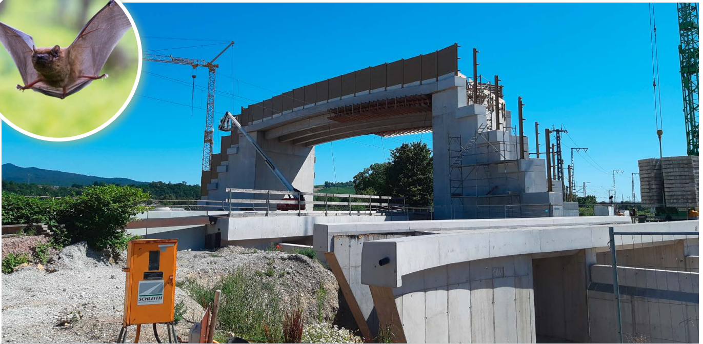
Querungshilfe für Fledermäuse
