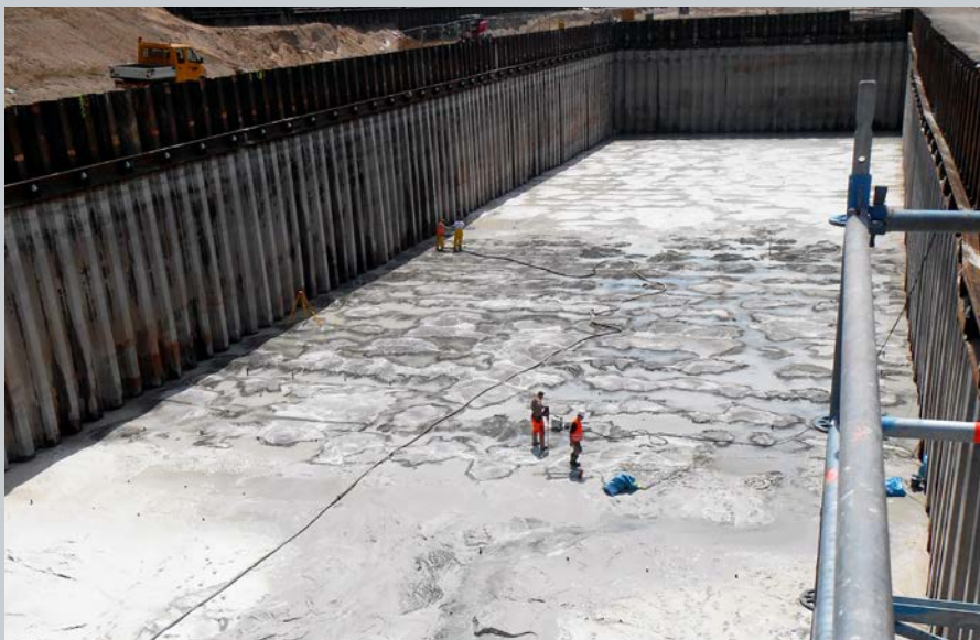
Das Wasser aus der zukünftigen Grundwasserwanne Nord für den Tunnel Rastatt wurde innerhalb von vier Wochen kontrolliert in den Federbach bei Ötigheim abgelassen – und zwar mithilfe einer Wasseraufbereitungsanlage. Bevor die Tunnelarbeiten starten können, muss nun die vorbereitete Grube vollständig trocknen. Dann beginnen die Betonarbeiten für die Grundwasserwanne und der Zusammenbau der Tunnelvortriebsmaschinen.
