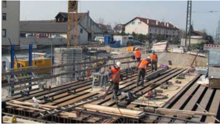
Die Eisenbahnüberführung (EÜ) Heldelinger Straße ist ebenfalls Teil der Baumaßnahmen in Haltingen. Mitte März wurden bereits die Stahlträger eingebaut, die das Bauwerk zukünftig tragen. Die dafür notwendige Vollsperrung der Heldelinger Straße ist bereits wieder aufgehoben.
